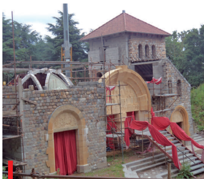
La nouvelle église en construction bénéficie du savoir-faire de chaque corps de métier.
